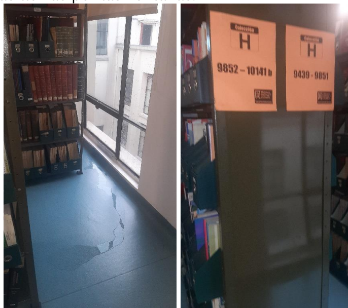
Imagen 227. Filtración por ventana sur, ubicada frente a las estanterías con signatura H-9852 a H-10141b y H-9439-9851.
