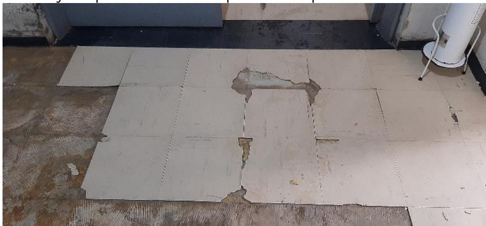
Imagen 5: Desprendimiento y deterioro acelerado del piso, en la zona de filtración norte.
