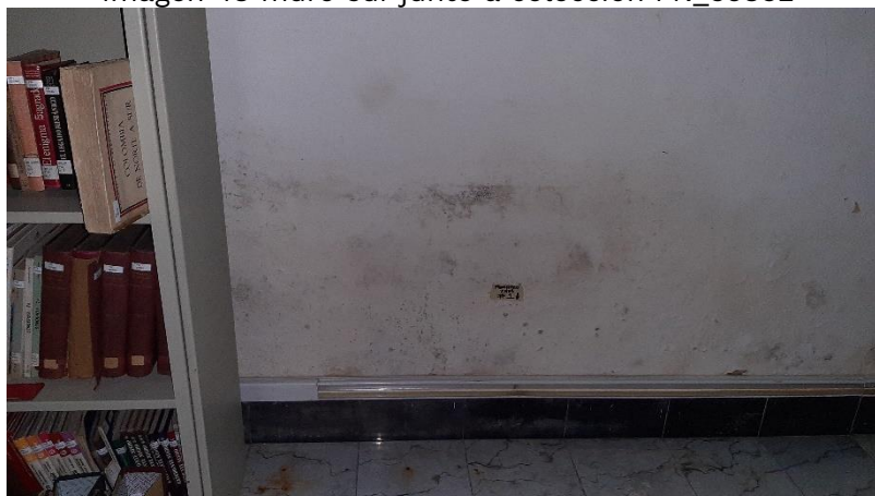
Imagen 49 muro norte junto al punto de control #1 de humedad del muro Imágenes: indicadores de humedad reserva Vásquez
