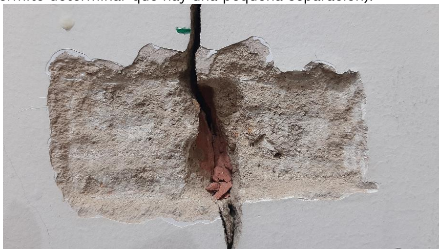
Fotografía 106: grieta de seguimiento 17 de agosto, después del temblor.
