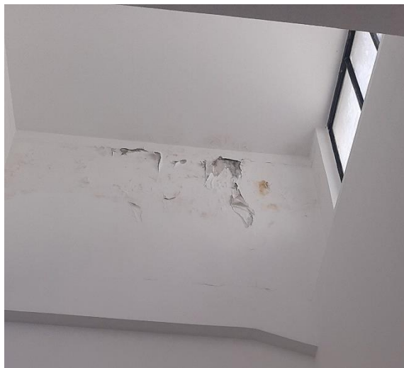
Imagen 218: filtración activa cafetería 4to piso, muro occidental.
