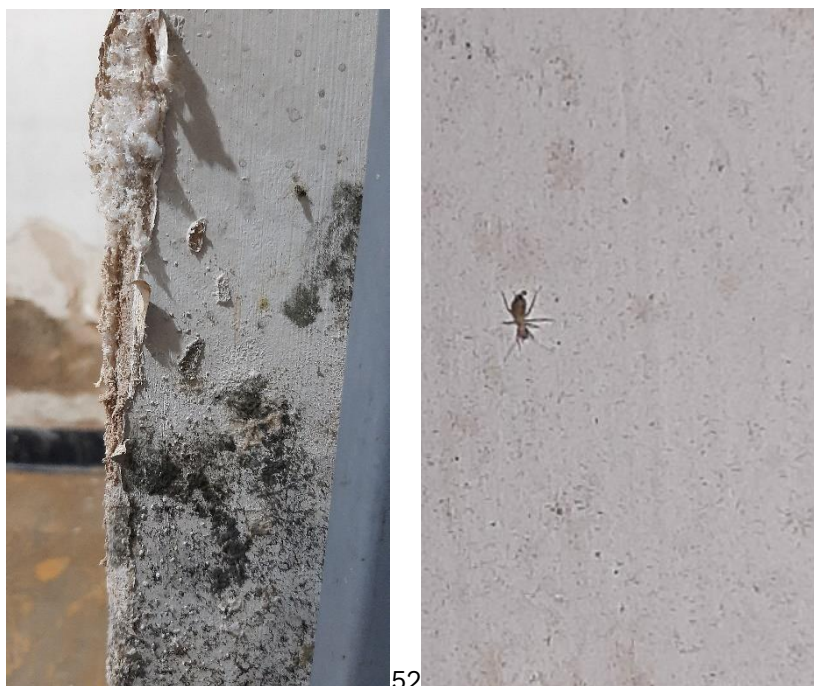
Imágenes: indicadores de deterioros y biodeterioros relacionados al proceso de filtración en el depósito de prensa (sótano BNC)
