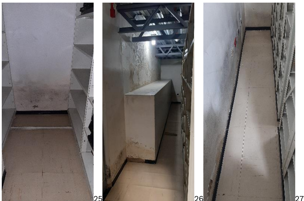
Imágenes 25, 26 y 27: zonas de humedad 1 y 2 del muro oriental de prensa
