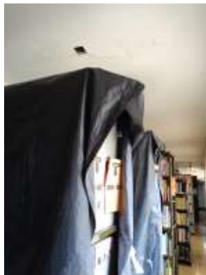
Imagen: se cubren de forma preventiva las estanterías que están debajo de las goteras.
