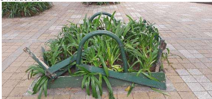
Imagen: estado inicial de las barandas externas (fotografía agosto 12 de 2024)
