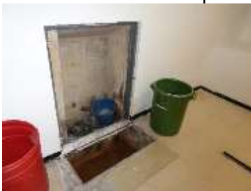
Imagen 32: zona de monitoreo No.1 de prensa con halos de humedad amarillos.
