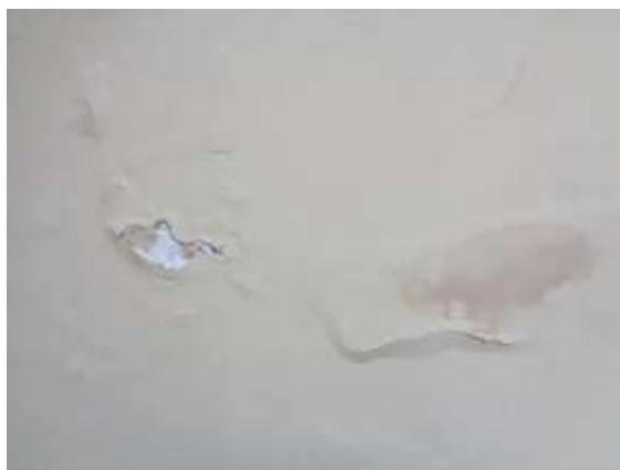
Imagen: detalle del muro sur de la sala hemerográfica con indicador de humedad.
