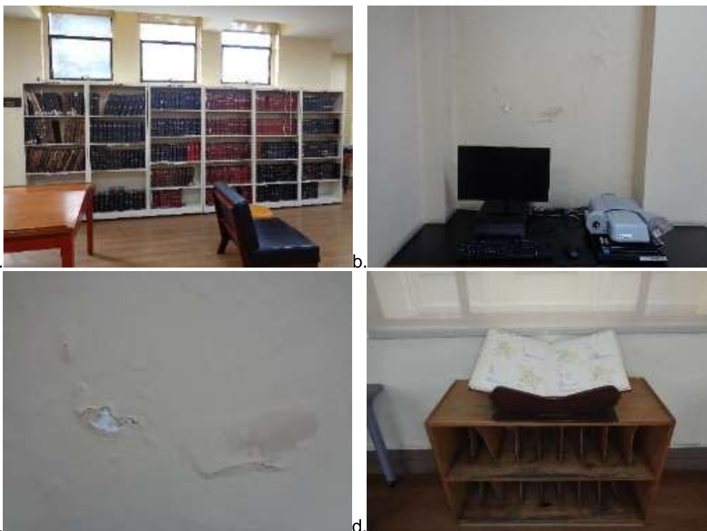
imágenes: Sala de consulta hemeroteca; a. Imagen general de la colección abierta de revistas; b. zona con indicadores de deterioro; c. detalle de los deterioros identificados en el muro sur de la sala de consulta; d. reubicación del atlas de Colombia.
