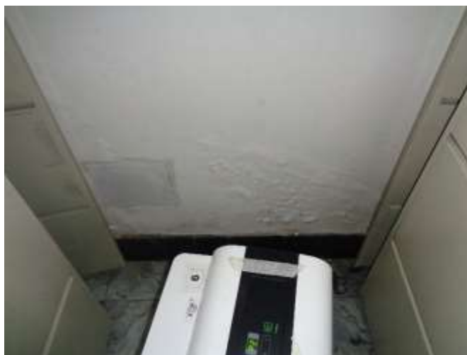
Imagen 68: indicadores de deterioro y biodeterioro
