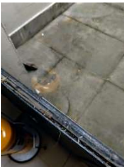
Imagen 102: Espacio entre el vidrio y el marco de la ventana debido al deterioro del sellado. Se evidencia acumulación de insectos, polvo y otros desechos.
