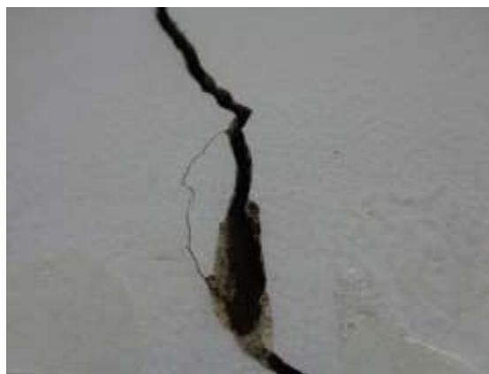
Imagen 90: se evidencian desprendimientos y fragmentos relacionados a la grieta. Estos tienen más de 2cm de alto y 5mm de profundidad.
