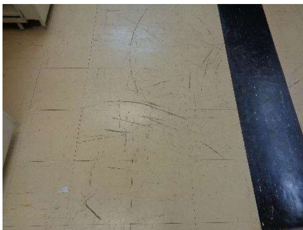
Imagen 63: detalle del estado actual de los pisos en reserva mezanine.
