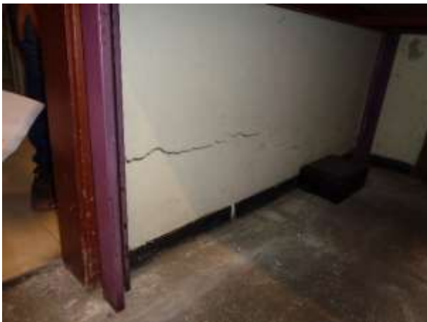
Imagen 82: ubicación de la grieta inferior ubicada en puerta garaje
