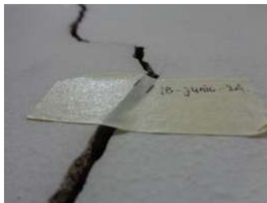
Imagen 65: identificación del desplazamiento mediante cinta en la zona de desprendimiento de la lámina de vidrio.
