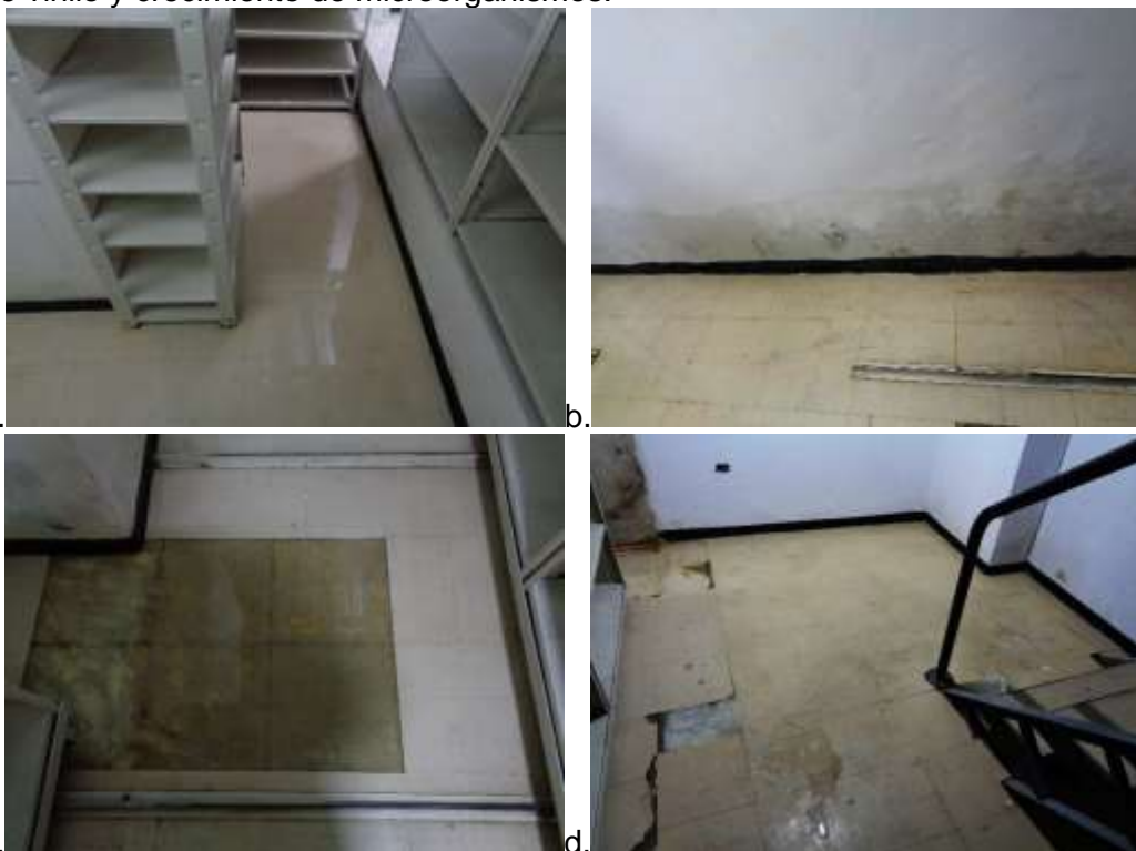
imágenes: a. filtración debajo de las estanterías. b. halos de humedad presentes en el muro oriental falso. c. desprendimiento del piso vinílico. d. empozamiento de agua.
