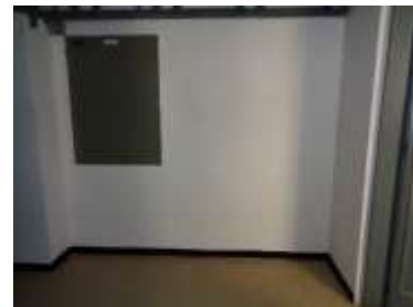
Imagen 34: zona de monitoreo No.3 apariencia final de la pared.
