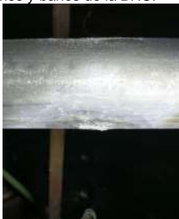
Imagen: detalle del deterioro del tubo
