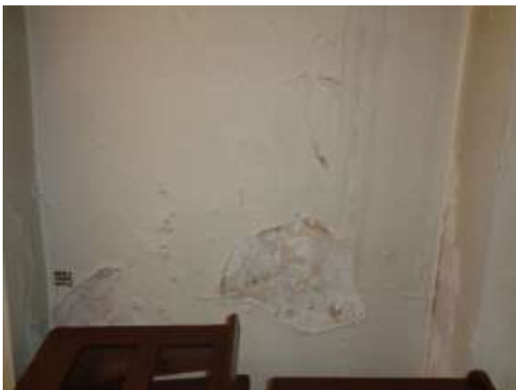
Imagen: humedad muro sur de Fondo Antigo
