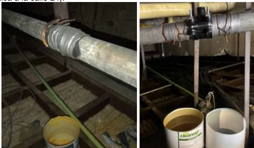
Imagen: procesos de reparación “artesanal y provisional” de tubos del primer piso que serán cambiados.
