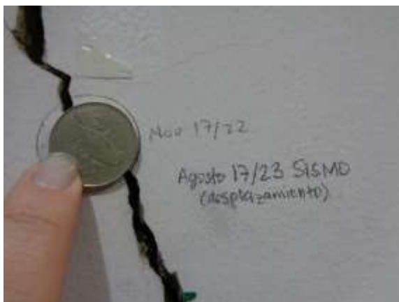
Imagen 87: zona de seguimiento y desplazamiento por sismo ocurrido en agosto 17 de 2023
