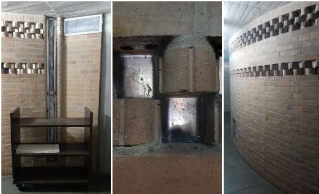
Imágenes 247-249. Sistemas arquitectónicos de ventilación en los depósitos del AGN y ubicación de cebos.
