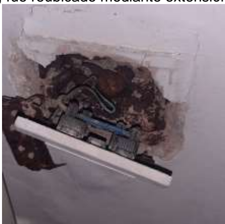
Imagen 5: Toma eléctrica del deshumidificador No.1 durante visita
