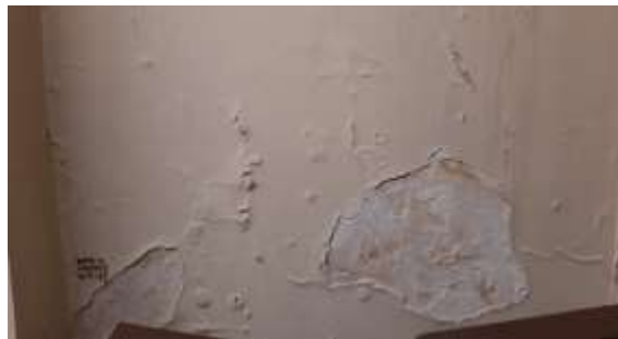
Imagen: detalle de la humedad presente en el muro sur del Fondo Antiguo
