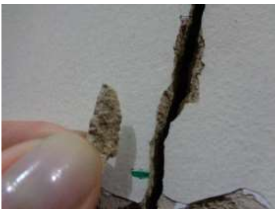
Imagen 89: se evidencian desprendimientos y fragmentos relacionados a la grieta. Estos tienen más de 2cm de alto y 5mm de profundidad.
