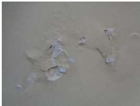
Imagen: detalle de los indicadores de humedad en el muro sur de la sala hemerográfica.
