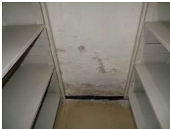
Imagen 29: indicador de humedad en el muro oriental de material en tránsito.
