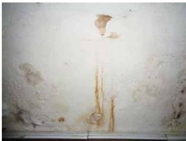
Imagen 105: detalle de los deterioros identificados en la pared norte de la reserva Vásquez.
