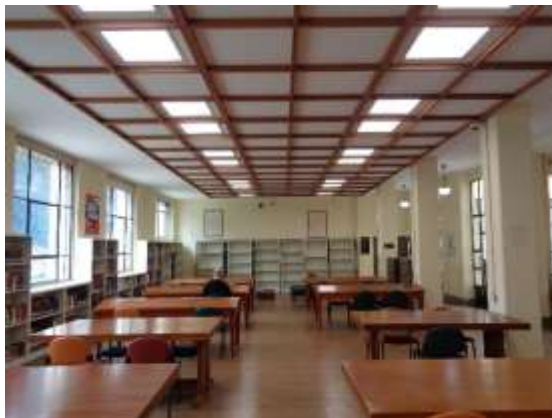
Imagen: estado de conservación sistema de iluminación.
