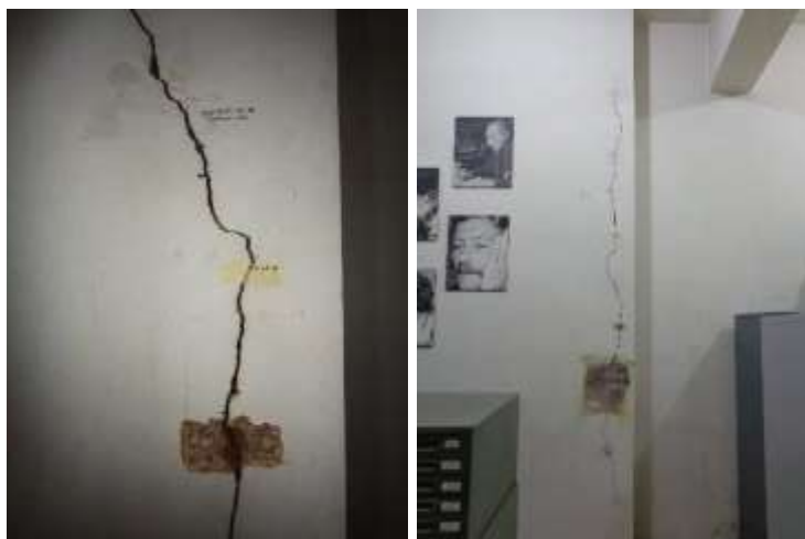
Imagen 126: fotografía grieta de seguimiento
