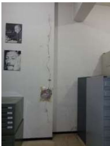
Imagen 85: grieta de seguimiento en la pared sur de la reserva de microfilm
