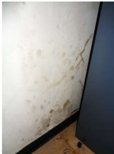
Imagen 107: detalle de los indicadores de deterioro por humedad y biodeterioro en la reserva microfilm y fotografía.
