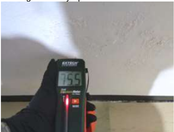
Imagen: registro de humedad en el punto 3 de seguimiento del muro oriental el día de la inundación.
