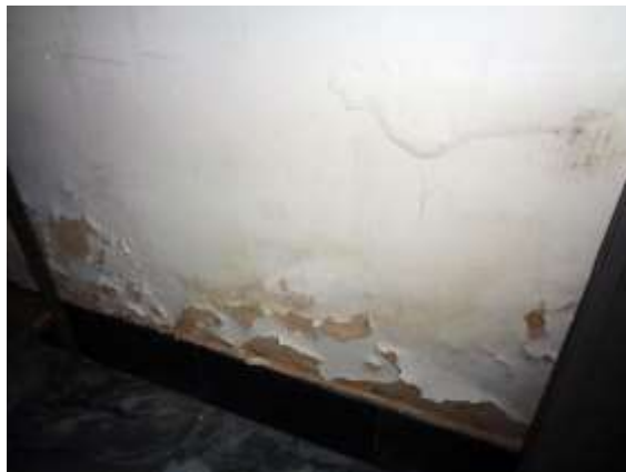
Imagen 117: indicadores de deterioro en la pared sur junto a las escaleras
