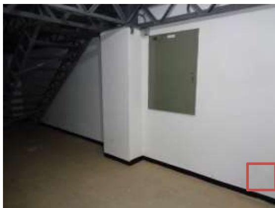
Imagen 91: ubicación general de las sales en el muro oriental del sótano (reserva de prensa).
