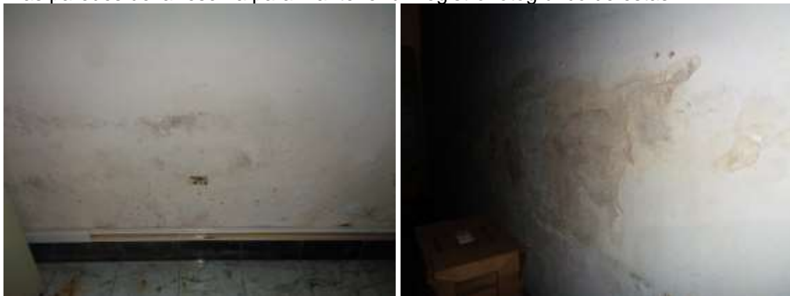
Imagen115: indicadores de humedad en el muro norte
