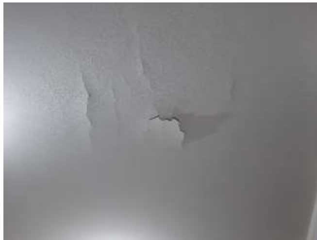
Imagen: detalle del desprendimiento del revoque y pintura del techo, en el descanso del tercer piso.
