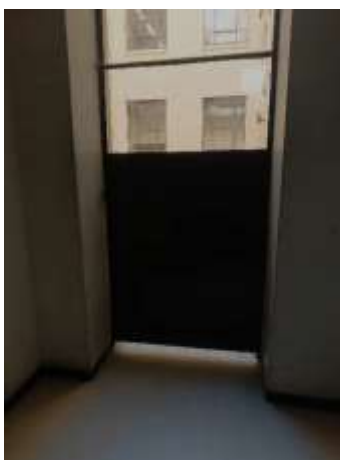
Imagen 113. Puerta del Depósito Hemerográfico con gran espacio debajo, el cual podría ser sellado para evitar la entrada de invertebrados y otro tipo de fauna desde el jardín.
