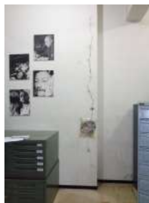
Imagen 57: fotografía general de la fisura de seguimiento, ubicada en el muro sur de la reserva.
