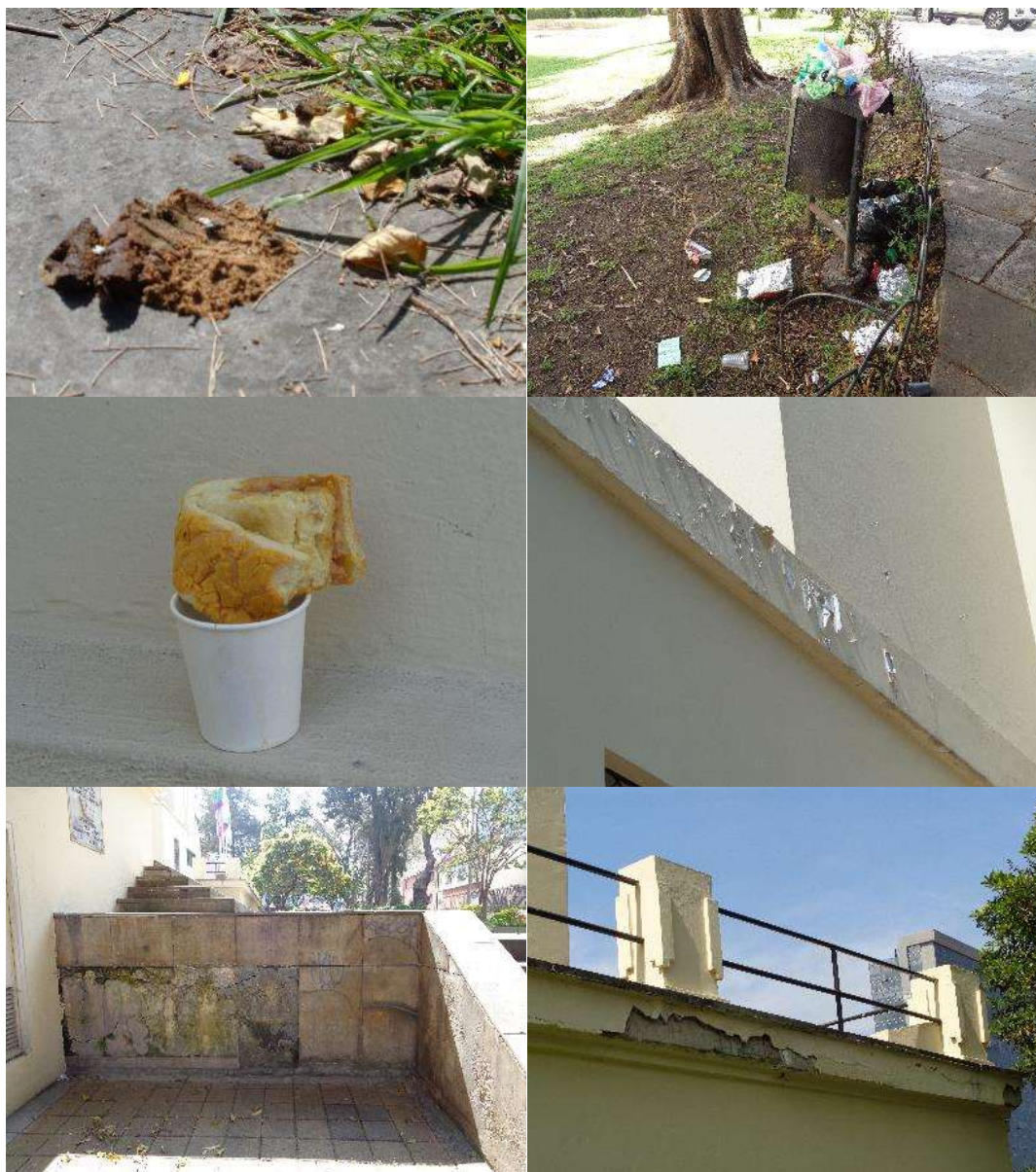
Imagen: Indicadores de deterioro en el exterior de la BNC
