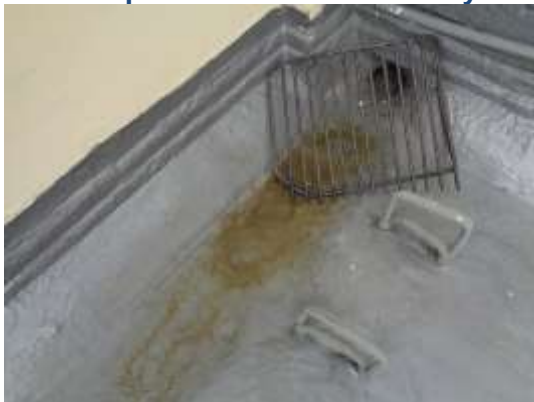
Imagen: detalle acumulación de suciedad en la terraza de revistas.
