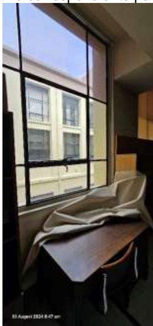
Imagen: fotografía de la persiana desprendida 03/08/24.
