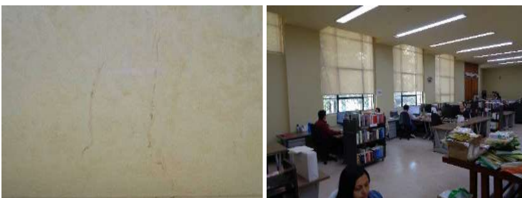
Imagen: seguimiento grieta y falta de EPP.
