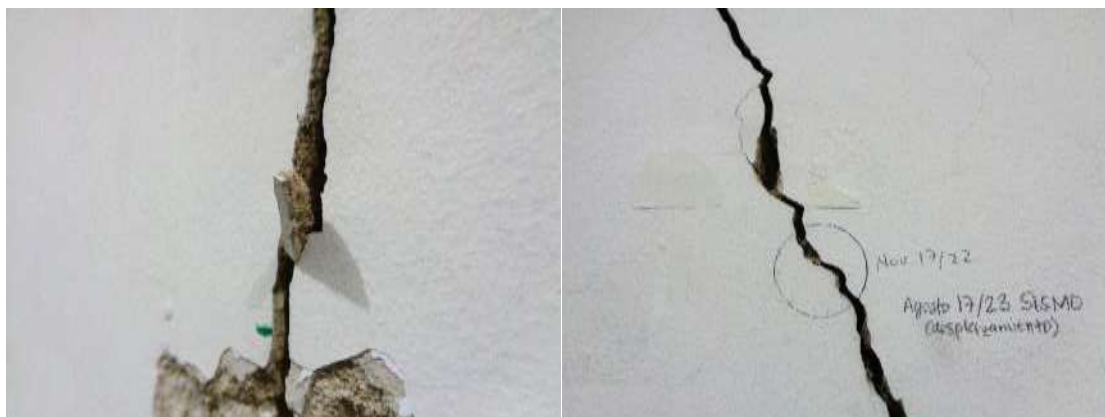
Imagen 127: detalle desprendimientos de la grieta de seguimiento.
