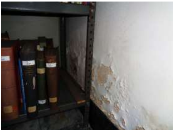
Imagen 116: indicadores de deterioro en la pared sur
