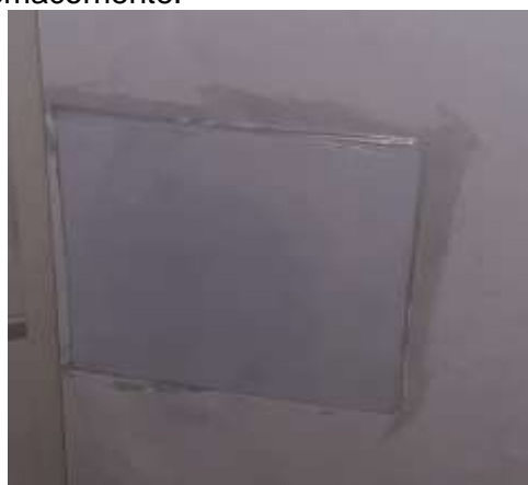
Imagen 6: foto documentación sellado de la toma por no contar con materiales para arreglo.
