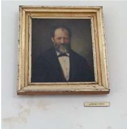
Imagen: Anselmo Pineda, ubicado en un muro con indicadores de humedad, lo que puede afectar en la conservación del caballete y el marco, presenta fragmentación de partes doradas del marco, desprendimiento de las juntas y separación del marco.
