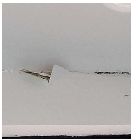
Imagen 74: indicador de filtración y humedad
