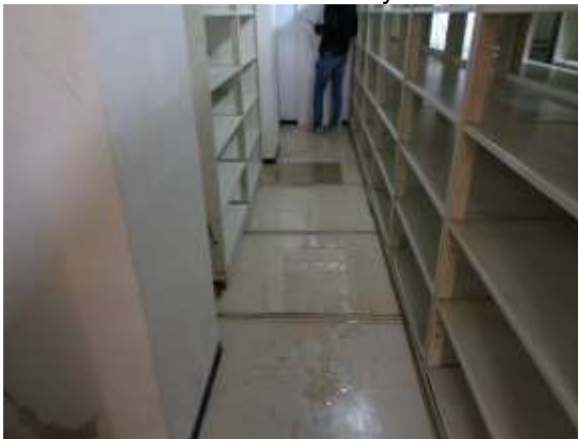
Imagen: Filtraciones muro oriental
