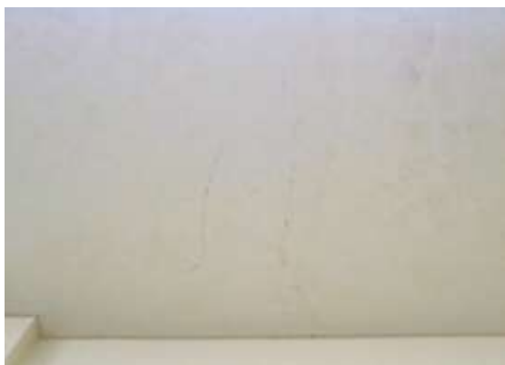
Imagen: grieta de seguimiento techo oficina noroccidental
