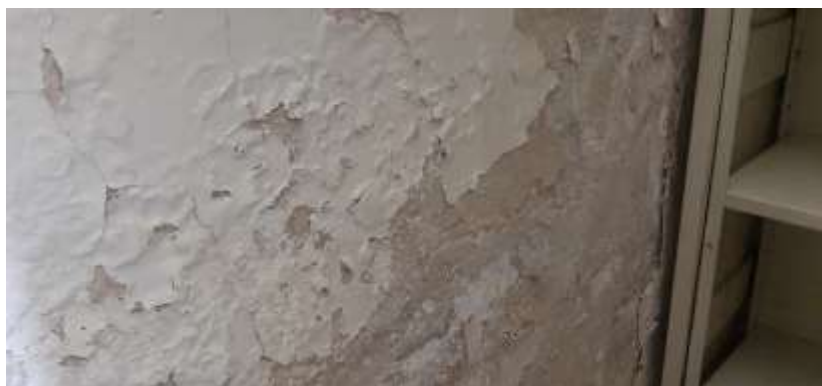
Imagen 84: detalle del deterioro que se observa en el muro oriental de material en tránsito.
