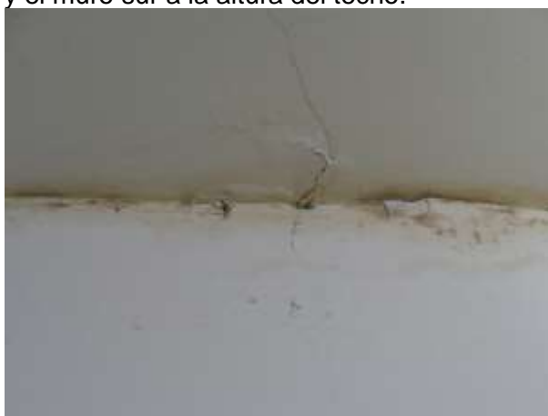
Imagen 108: detalle de la zona con humedad en el techo del mezanine
