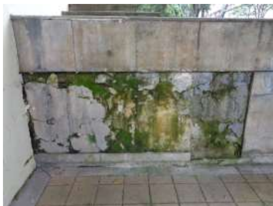
Imagen: desprendimiento intencional de piedra muñeca junto al cuero de las motobombas de la calle 24
