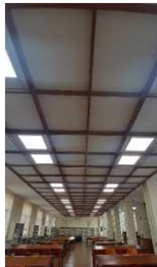
Imagen: fotografía final de la sala con nueva iluminación
