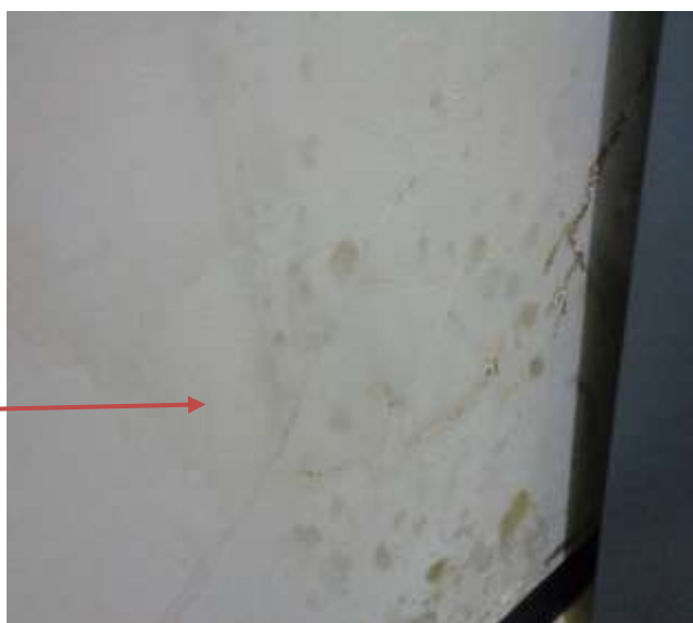
Imagen 67: detalle de los indicadores de humedad y biodeterioro asociados a patologías estructurales de edificio.
