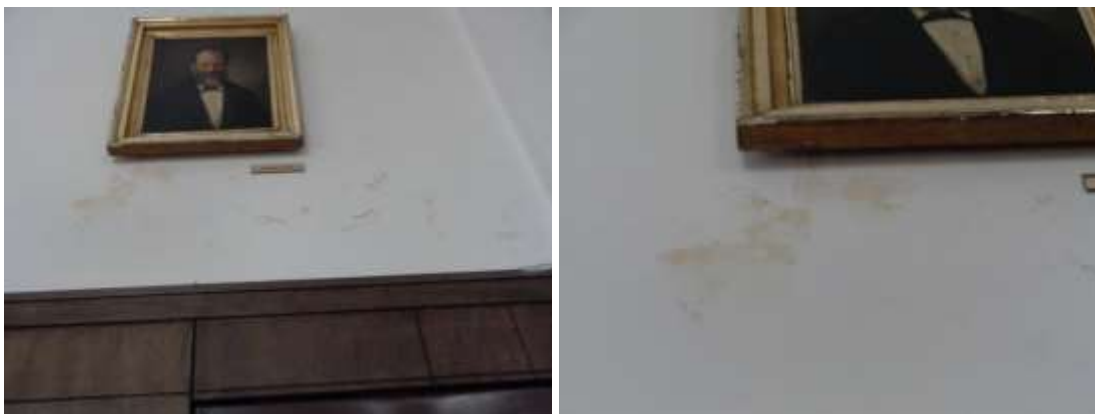
Imagen: fotografía general y detalle de los indicadores de deterioro ocasionados por humedad en el muro oriental de dirección.
