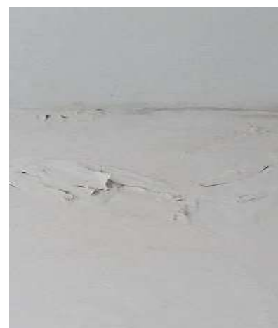
Imagen 75: indicador de filtración y humedad
