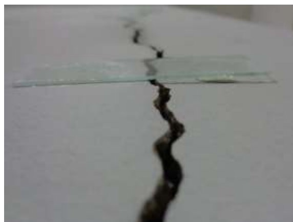
Imagen 88: detalle zona de desprendimiento de la lámina de vidrio. Permite observar el desplazamiento de los muros.
