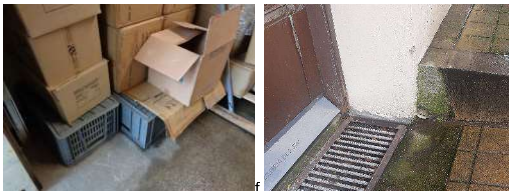
Imagen 135: a-e.detalle de los indicadores de deterioro identificados en puerta garaje en los marcos y estivas de madera. f.Canaleta por la que ingresan las ratas.
