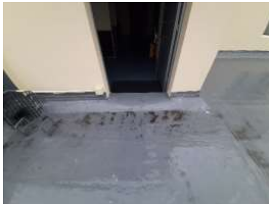
Imagen: Detalle puerta de ingreso a Conservación y la acumulación de suciedad en la terraza.
