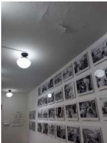
Imagen: foto de la exposición de Nereo y el deterioro en el techo del descanso del tercer piso.
