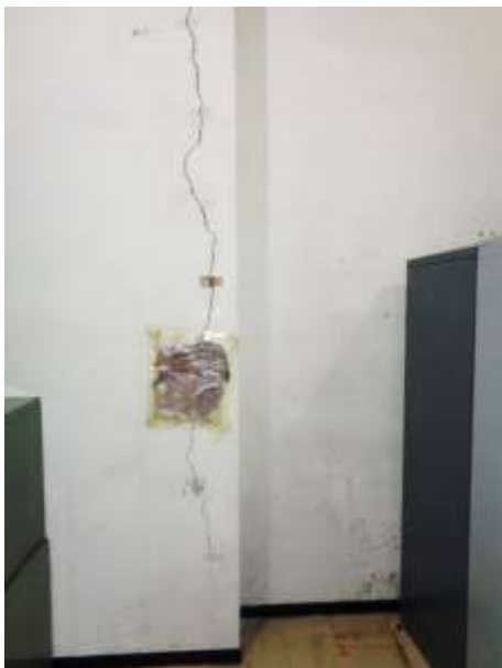
Imagen 106: grieta de seguimiento en reserva de microfilm y fotografía.
