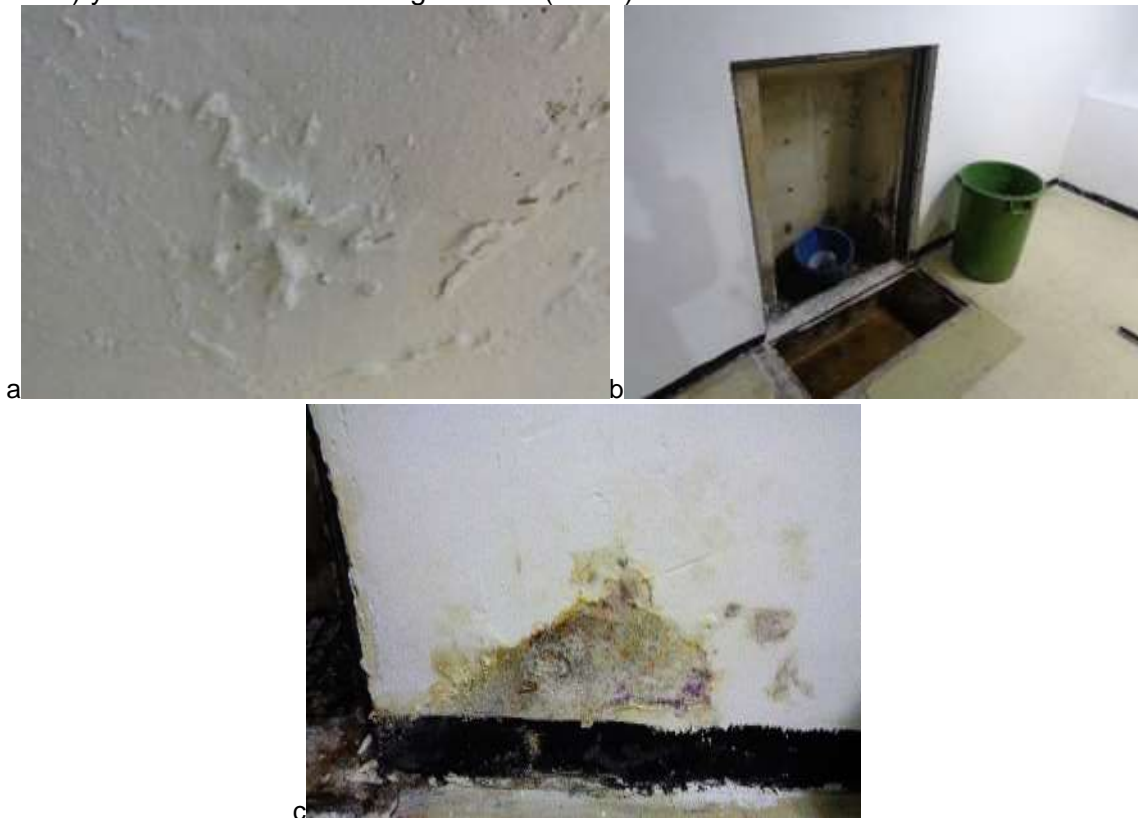
Imagen 131: a. muro oriental de prensa e indicadores de humedad. B. trampa de agua y c. biodeterioro en el muro ubicado junto a la trampa de agua.
