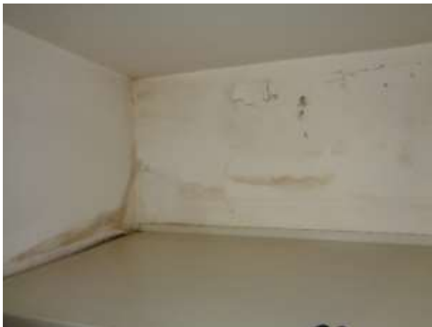
Imagen 51: indicadores de humedad en el techo de mezanine, sobre la estantería de L-6239 y L-6507
