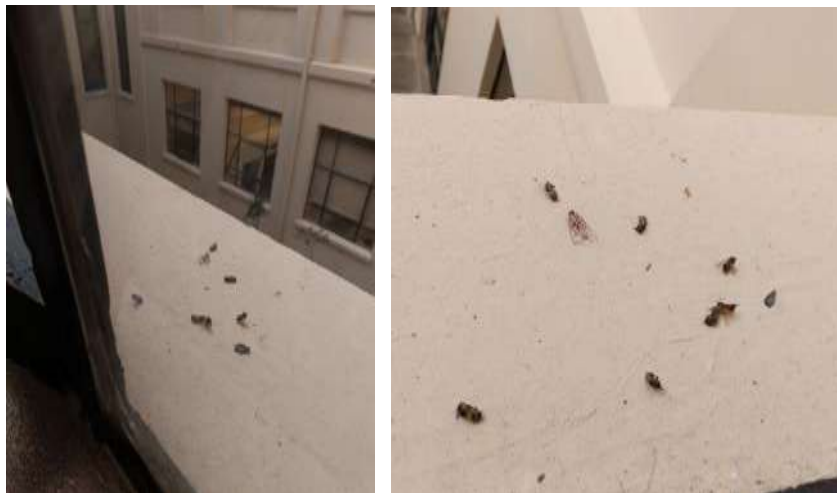
Imagen. Insectos en proceso de descomposición sobre el alféizar externo de una ventana del Centro de Documentación Musical.
