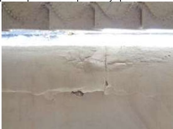
Imagen: detalle de los indicadores de humedad en el muro oriental de la reserva
