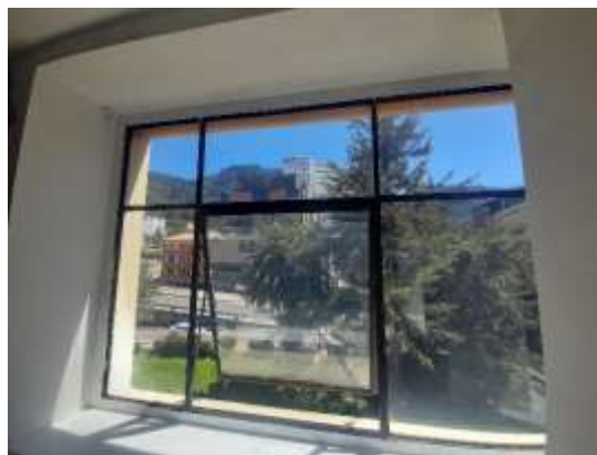
Imagen: Apertura de ventanas externas de la reserva suroriental y ausencia de persianas.
