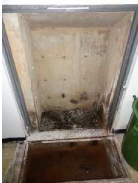
Imagen 109: trampa de agua sin la puerta
