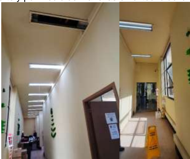
Imagen: zona de filtración de agua, frente a la puerta de la oficina noroccidental de Desarrollo de Colecciones.
