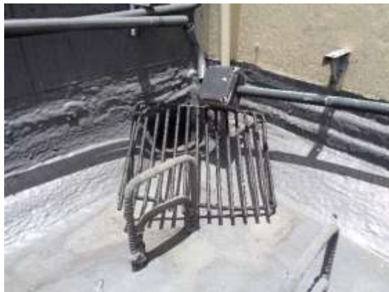
Imagen: detalle desagüe terraza suroriental
