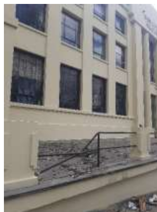
Imagen: detalle de la fractura y deterioro de las barandas.
