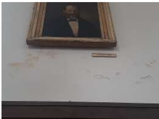
Imagen: manchas de humedad y desprendimiento de revoque de la pared oriental donde está ubicado el cuadro de Anselmo Pineda
