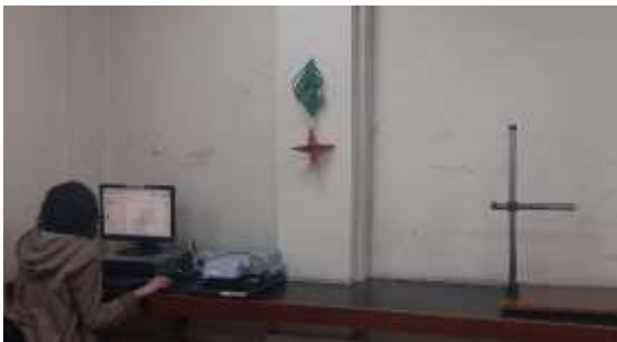
Imagen: detalle de la humedad presente en la sala de hemeroteca
