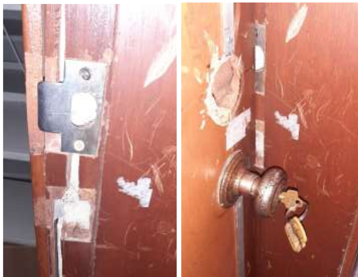
Imagen 16: detalle del estado de conservación de la chapa y la puerta de la reserva.
