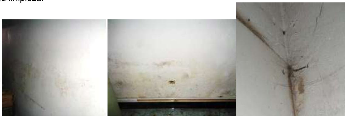
Imagen 130: Vásquez humedad en muro norte y telarañas en el cuarto de los vestidos.
