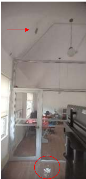
Imagen: zona de desprendimiento de pintura de techo.
