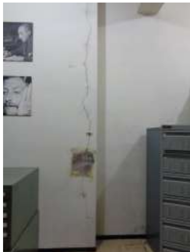
Imagen 64: grieta de seguimiento
