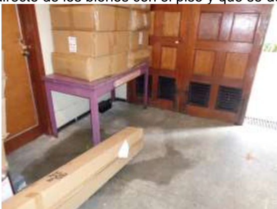
Imagen 30: filtración por debajo de puerta garaje
