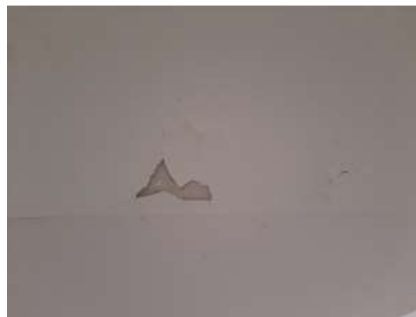
Imagen: detalle del desprendimiento y expansión de las fisuras.
