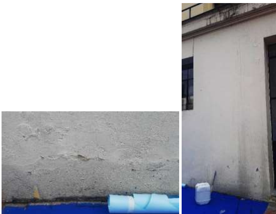
Imagen 128: puerta 5 externa y nivel de deterioro de los muros en la zona superior e inferior de la pared.
