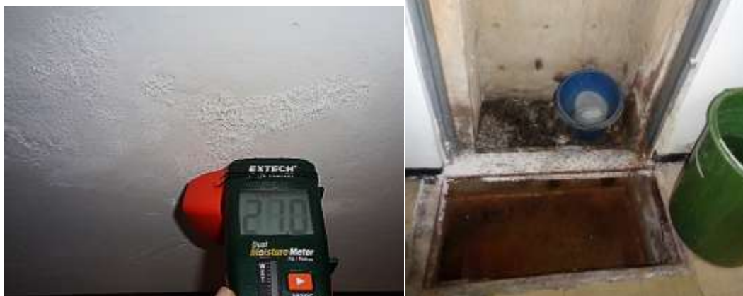
Imagen 120: indicadores de deterioro y biodeterioro en el muro oriental del sótano de prensa puntos de seguimiento No.3 y 1.
