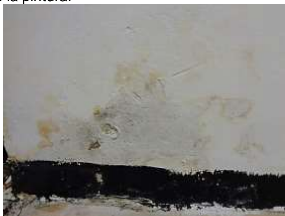
Imagen 70: detalle de indicadores de biodeterioro en la trampa de agua.
