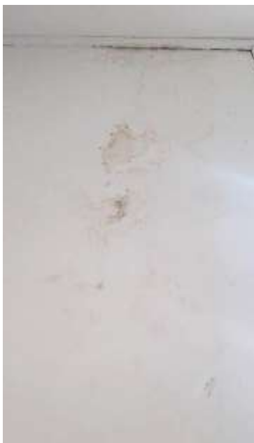
Imagen 98: presencia de manchas de humedad en el muro suroccidental del sótano.
