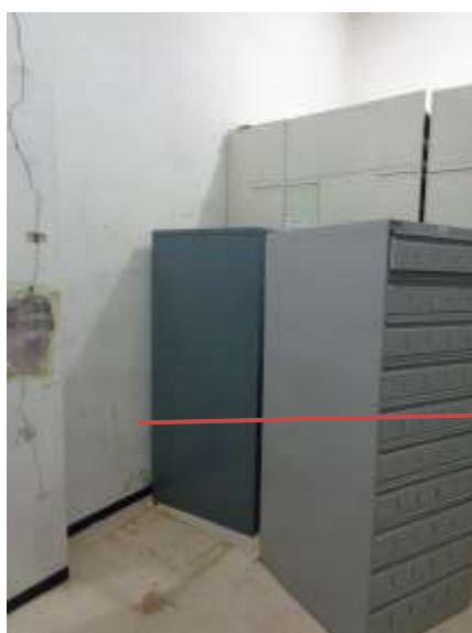
Imagen 66: ubicación de las manchas de humedad junto a la grieta de seguimiento
