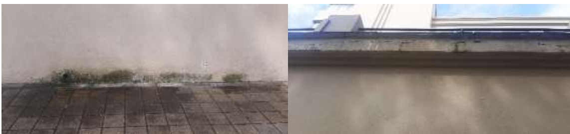
Imagen: indicadores de deterioro en el exterior de puerta garaje
