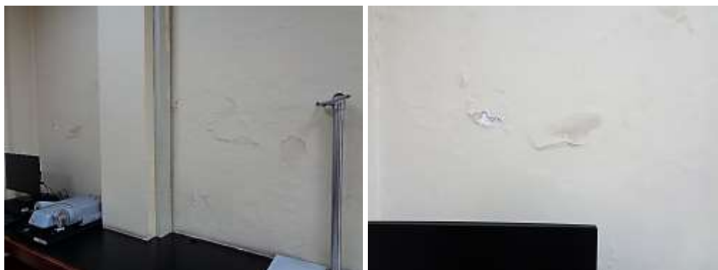
Imagen: muro sur de la hemeroteca, foto general y detalle del deterioro ocasionado por humedad.
