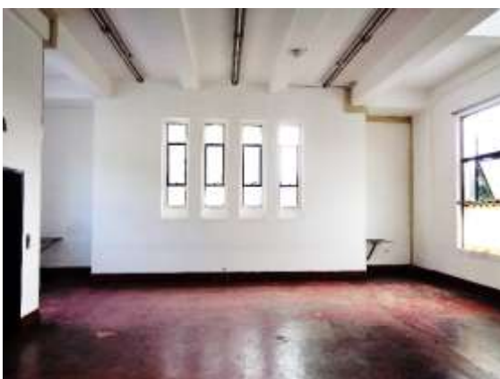
Imagen: fotografía antes del proceso de reparación y mantenimiento del piso en cafetería (07 de marzo del 2024)
