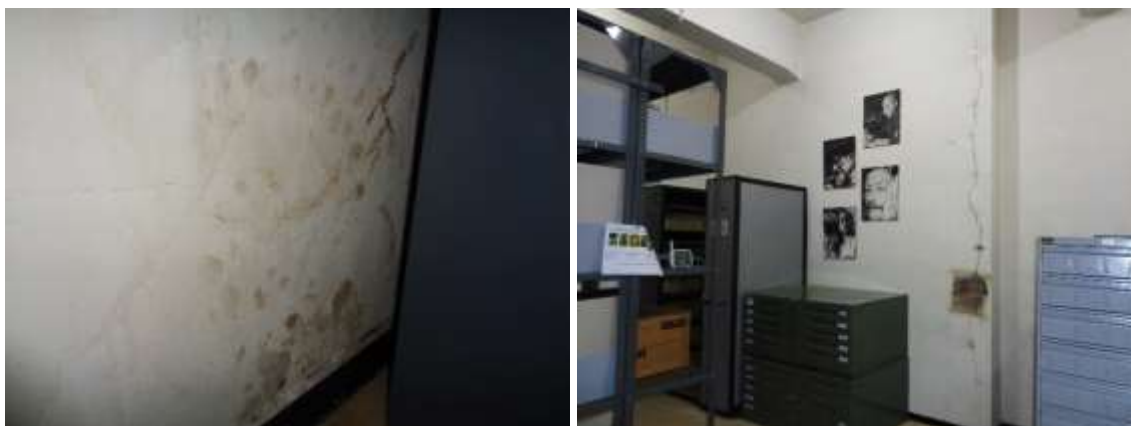
Imagen 121: indicadores de biodeterioro y deterioro en reserva Microfilm y fotografía (grieta de seguimiento).
